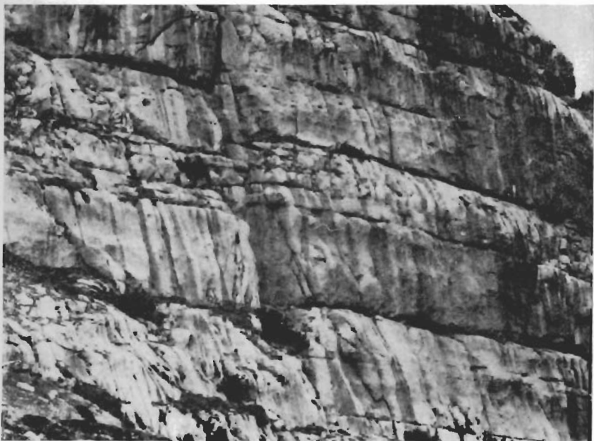
FIG. 4 — FIANCO SINISTRO DEL «VAN» DELLA MOIAZZETTA. In alto: visione complessiva; in basso: la parete interessata dalla corrosione. (fot. A. De Fanti)
