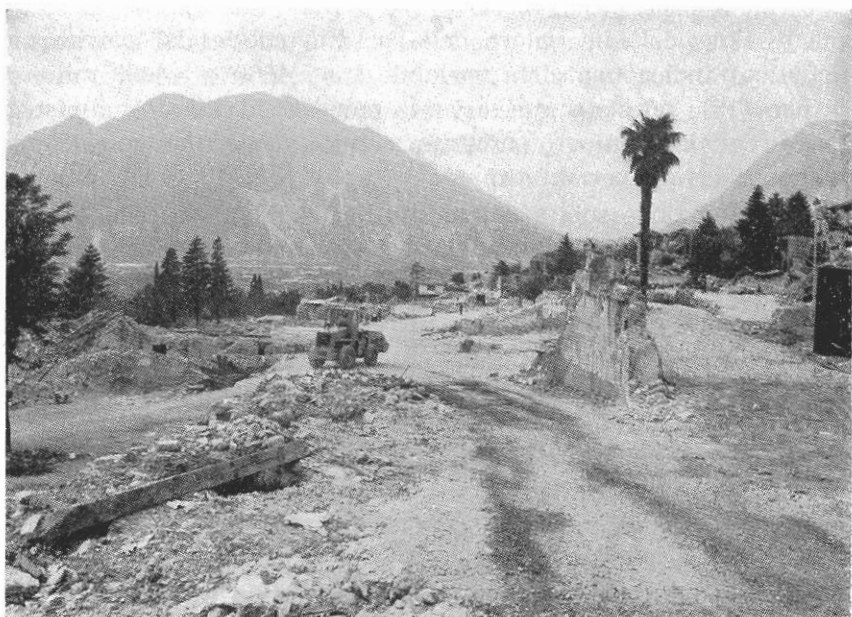
FIG. 3 — IL CENTRO STORICO DI GEMONA DEL FRIULI DOPO LO SGOMBERO DELLE MACERIE.
